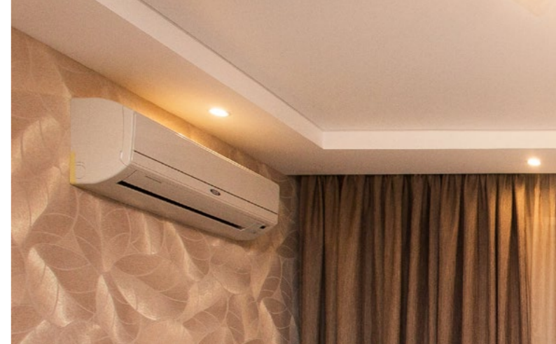
Установлена сплит-система для комфортной температуры
